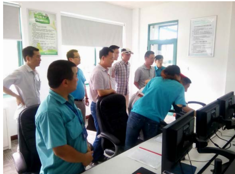
临城水厂中央控制室
